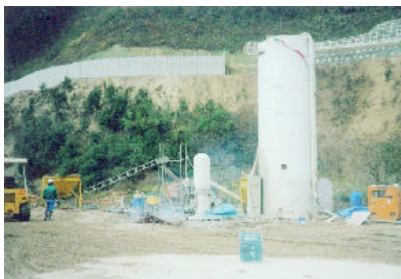
写真-3 気泡混合土製造プラント
