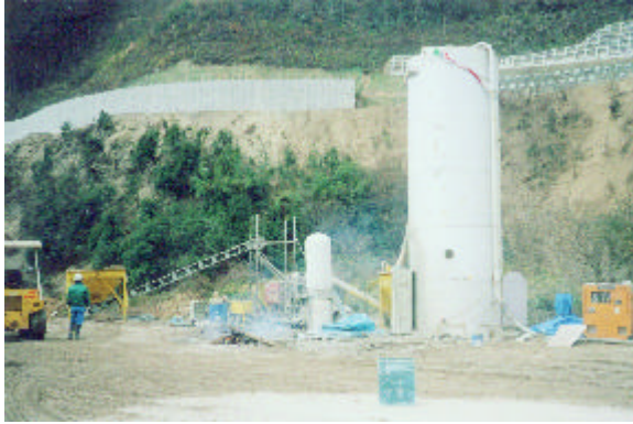
写真 - 1 気泡混合土製造プラント
